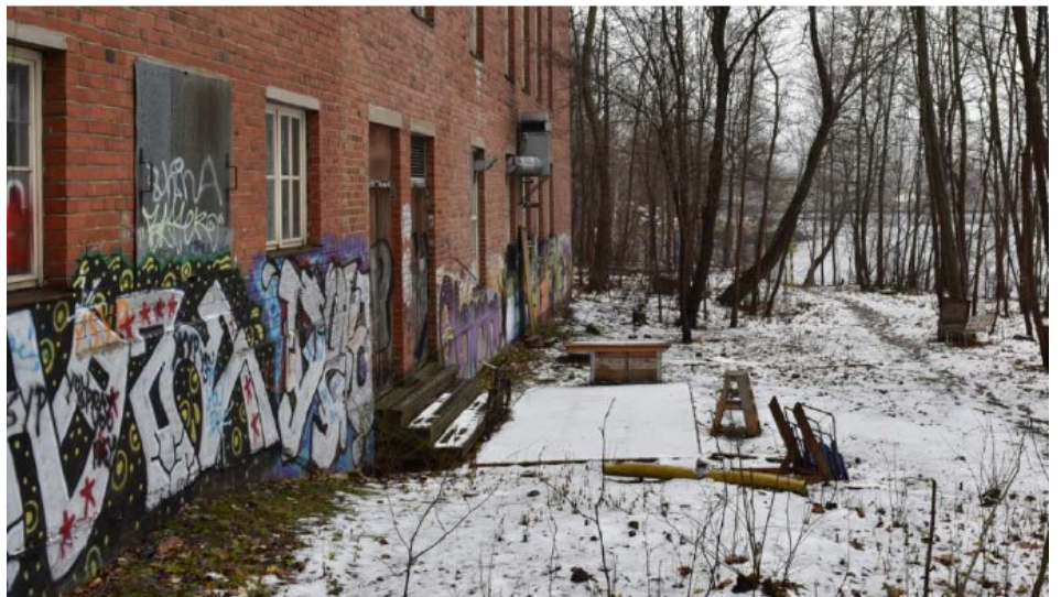
Kuva 7: Entisen Trikootehtaan voimalaitoksen punatiilinen julkisivu on graffitien peittämä. Voimalarakennuksessa on lepakoiden lisääntymis- ja levähdyspaikka. Kuva Teija Ahola, 2017.
